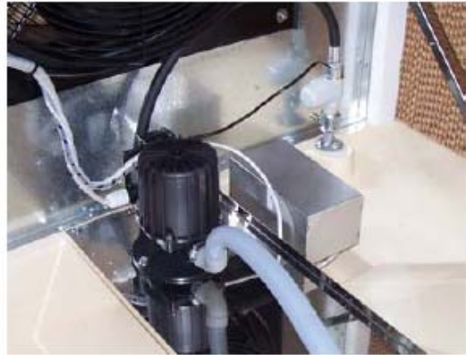
- pompa de recirculare
